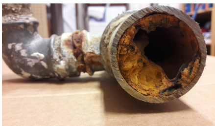
Över 50 år gamla vattenledningar kan nästan växa igen och försvaga vattnets kvalitet.
