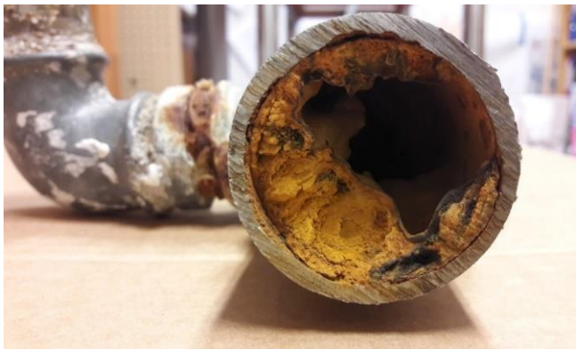
Kuva 11. Uusien runkovesijohdojen hyödyt eivät näy asiakkaalla, jos vesi seisoo vanhoissa tonttivesijohdoissa ja lähes umpeen kasvaneista tonttijohdoista liruttaa vettä huonolla paineella. Kuvan vesijohdon sisähalkaisija on 40 mm.
