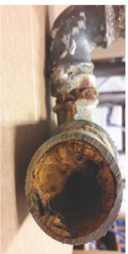
Yli 50 vuotta vanhat vesijohdot voivat kasvaa lähes umpeen ja heikentää veden laatua.
