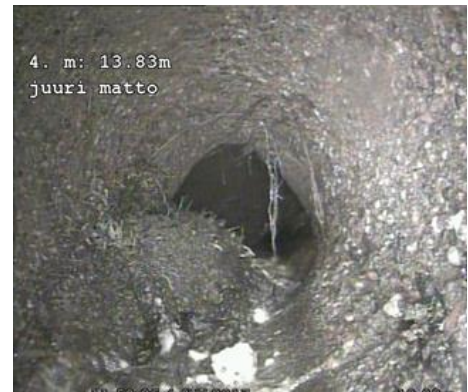
Kuva 12. 150 mm betoniviemärisessä on pintavauriota ja sinne on tunkeutunut juuria. Viemärin tukkeutumisriski on ilmeinen.
